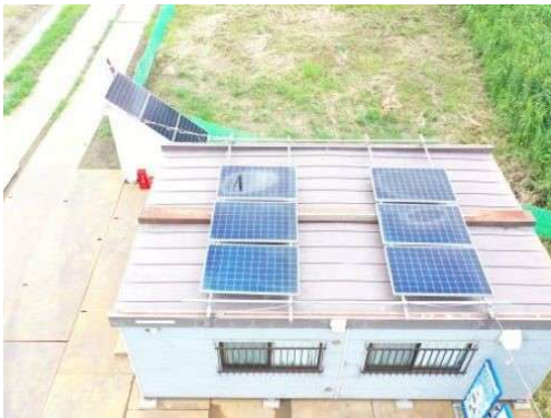
ソーラーシステムを利用した休憩所
