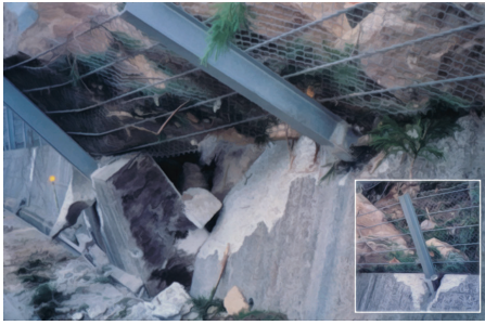
写真-2 擁壁支柱基部近傍における損傷例 2)
