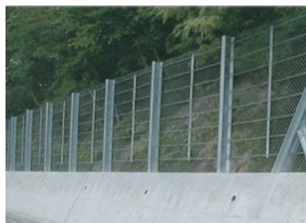
写真-1 擁壁天端に設置される従来型落石防護柵の一例
